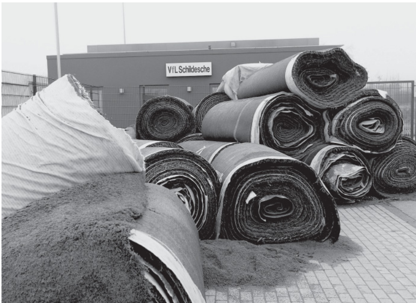
Eingerollt: Der Kunstrasen auf dem Schildescher Sportplatz am Viadukt ist abgetragen. Er platze immer wieder auf und zeigte Risse. Deshalb musste der Platz mehr als ein Dutzend Mal repariert werden. Im Frühjahr soll ein neuer Belag verlegt werden. FOTOS: WOLFGANG RUDOLF
